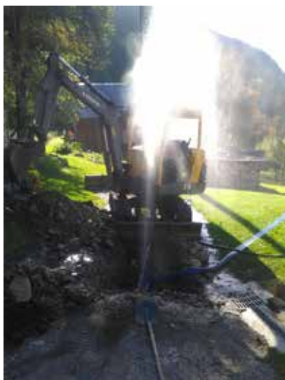
Fuite d'eau mont evian
